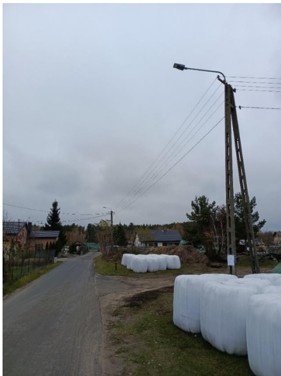
Źródło: Urząd Gminy w Aleksandrowie Kujawskim „Podniesienie standardu oświetlenia drogowego po przez założenie dwóch sztuk opraw typu LED w miejscowości Otłoczyn, ul. Piaskowa”
